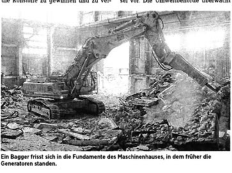
Ein Bagger frisst sich in die Fundamente des Maschinenhauses, in dem früher die Generatoren standen.
