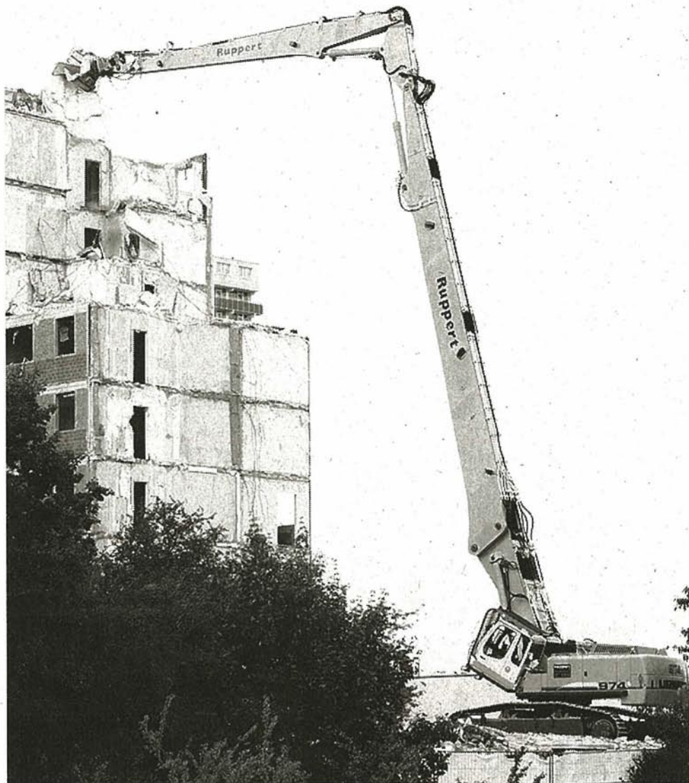
Der ca. 127 t schwere Abbruchbagger R 974 C HD-EW verfügt über eine 41-m-Abbruchausrüstung und kann mit bis zu 3 t Werkzeuggewicht bei maximal 18 m Ausladung arbeiten.
