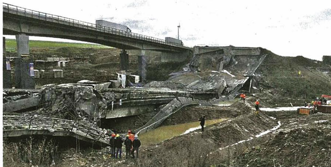
8500 Tonnen Betonteile im Talgrund: Ende Januar soll die Straße zwischen Theilheim (Lkr. Würzburg) und Biebelried (Lkr. Kitzingen) wieder passierbar sein.
